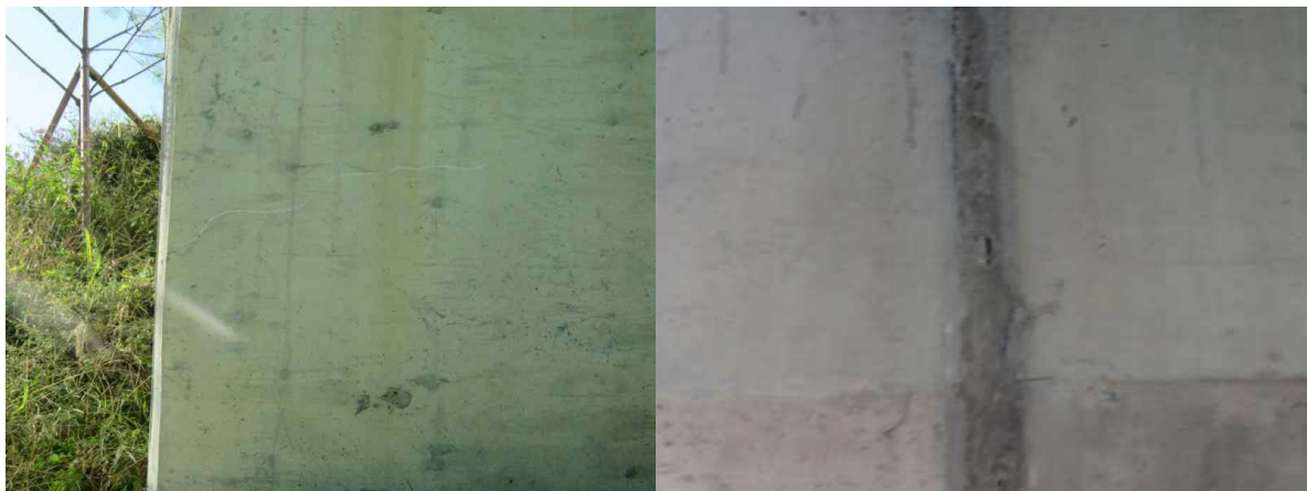
< 교대 A1 흥벽 균열 발생 >
