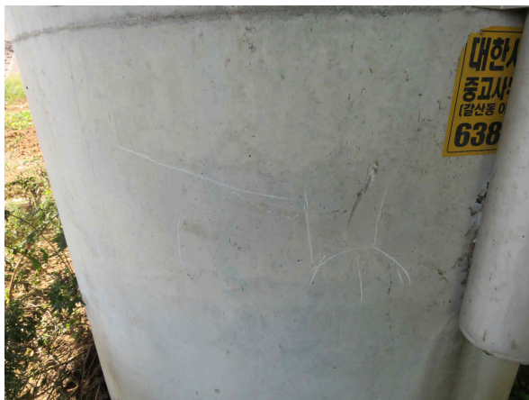
< 교각 P1 망상균열 발생 >
