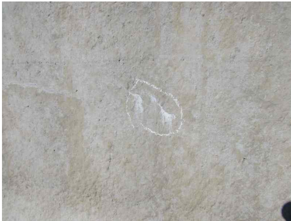
< S2 중앙분리대 균열 백태 발생 >
